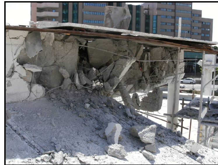
TRAVE DISARTICOLATA DALL'ESPLOSIONE
